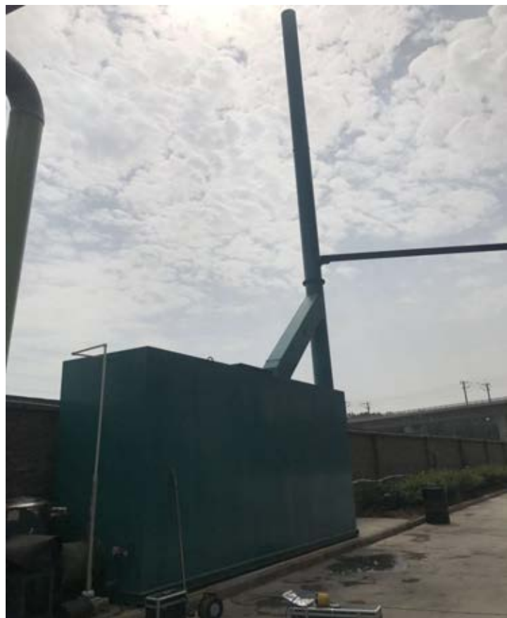
生物净化室与 15m 排气筒
